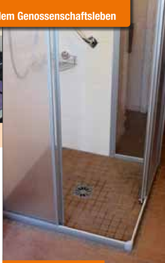
Die bodengleiche Dusche
